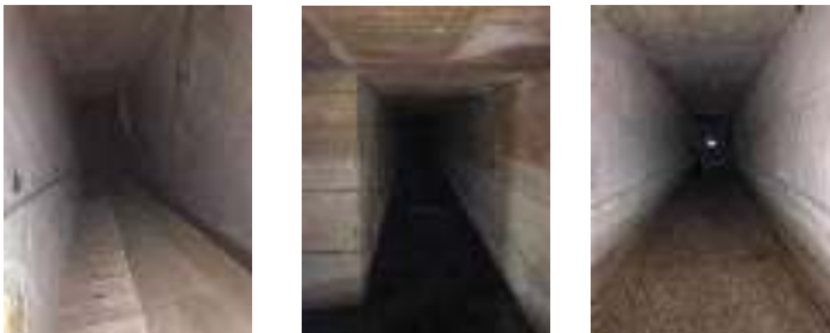
Imagen 1, Imagen 2, Imagen 3. Estado de la Estructura de Concreto y Compuerta
